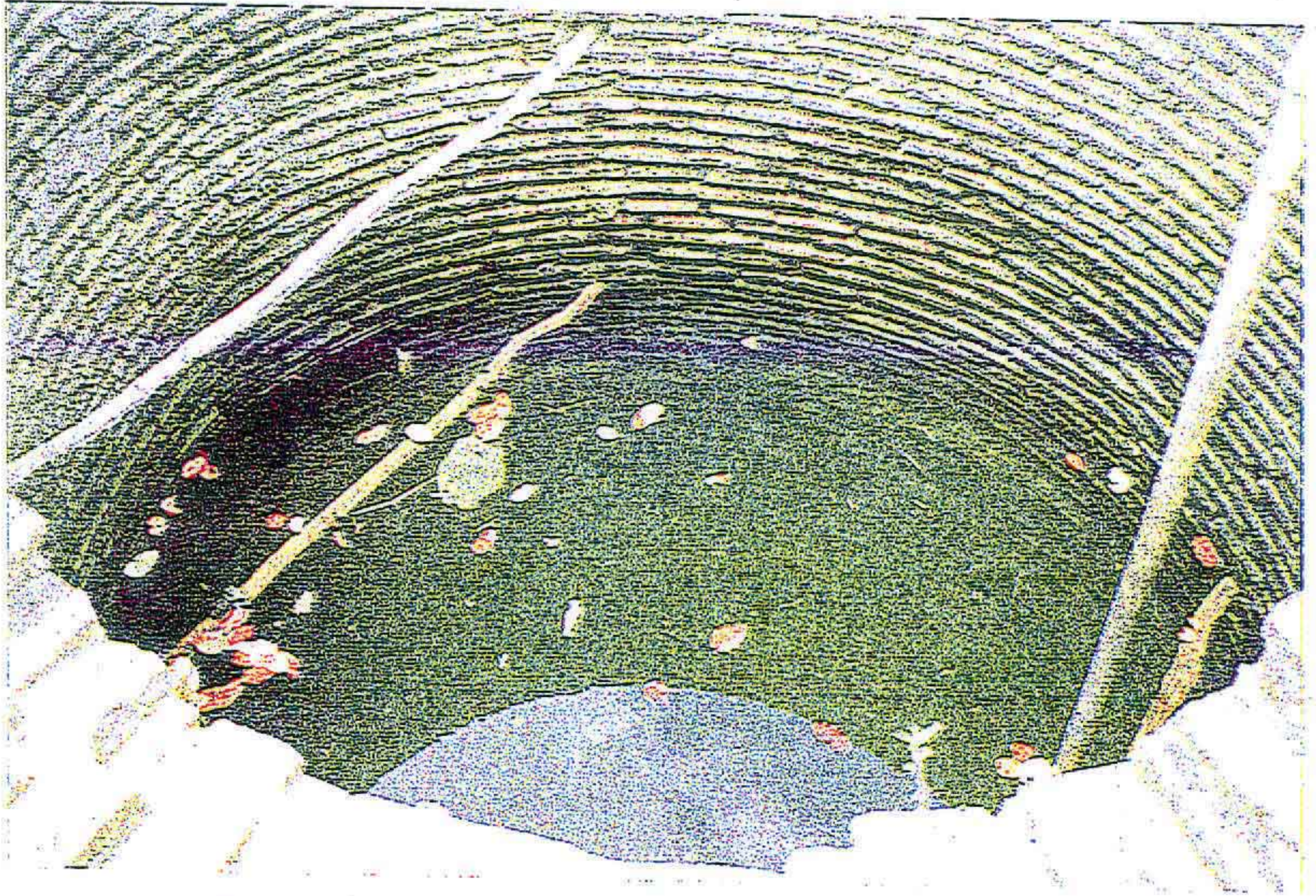
Figura 11 - Poço amazonas no matadouro de Uruburetama (lat.: 03° 37' 15" lon.: 39° 29' 49")
